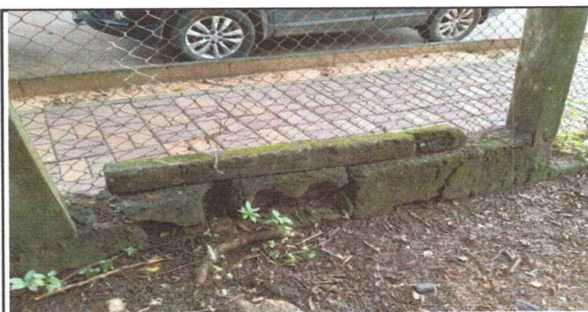
Foto 5: El muro perimetral en mal estado.
