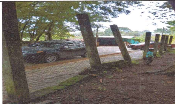
Foto 4: Parte de los pilares del muro perimetral apunto de caer, los sostienen unicamente la malla.
