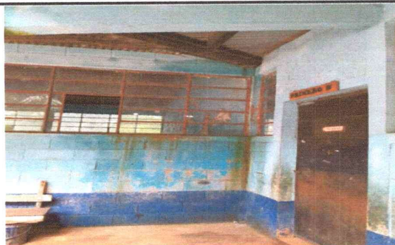
Foto 2: Pared de las aulas donde se filtra el agua por tener láminas en mal estado.
