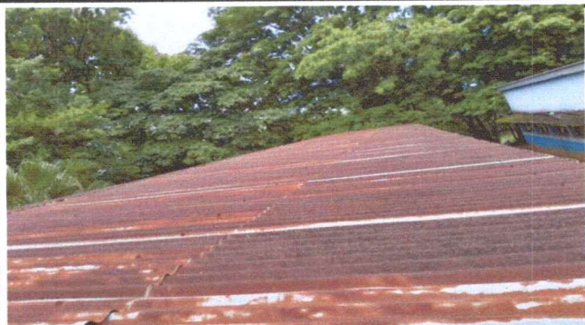
Foto1: La cubierta de lámina se encuentra en muy mal estado. En época de lluvia se filtra el agua a las aulas.
