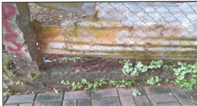
Foto 6: La malla en mal estado del muro perimetral.
